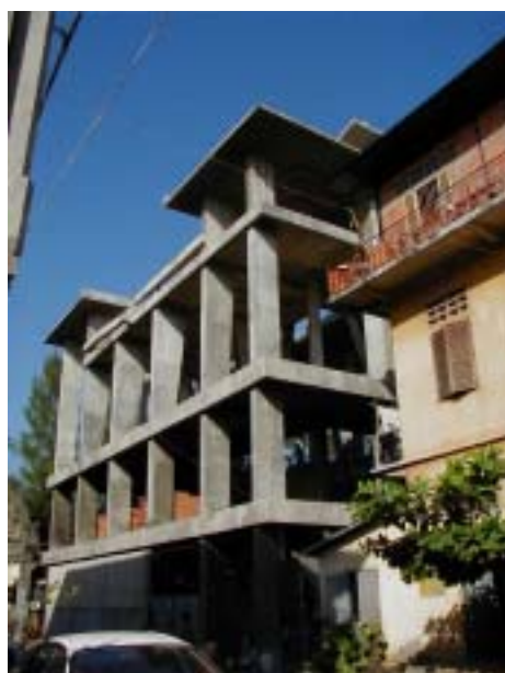
写真 プノンペンのウナローム寺院内に建設中の「ひろしまハウス」
